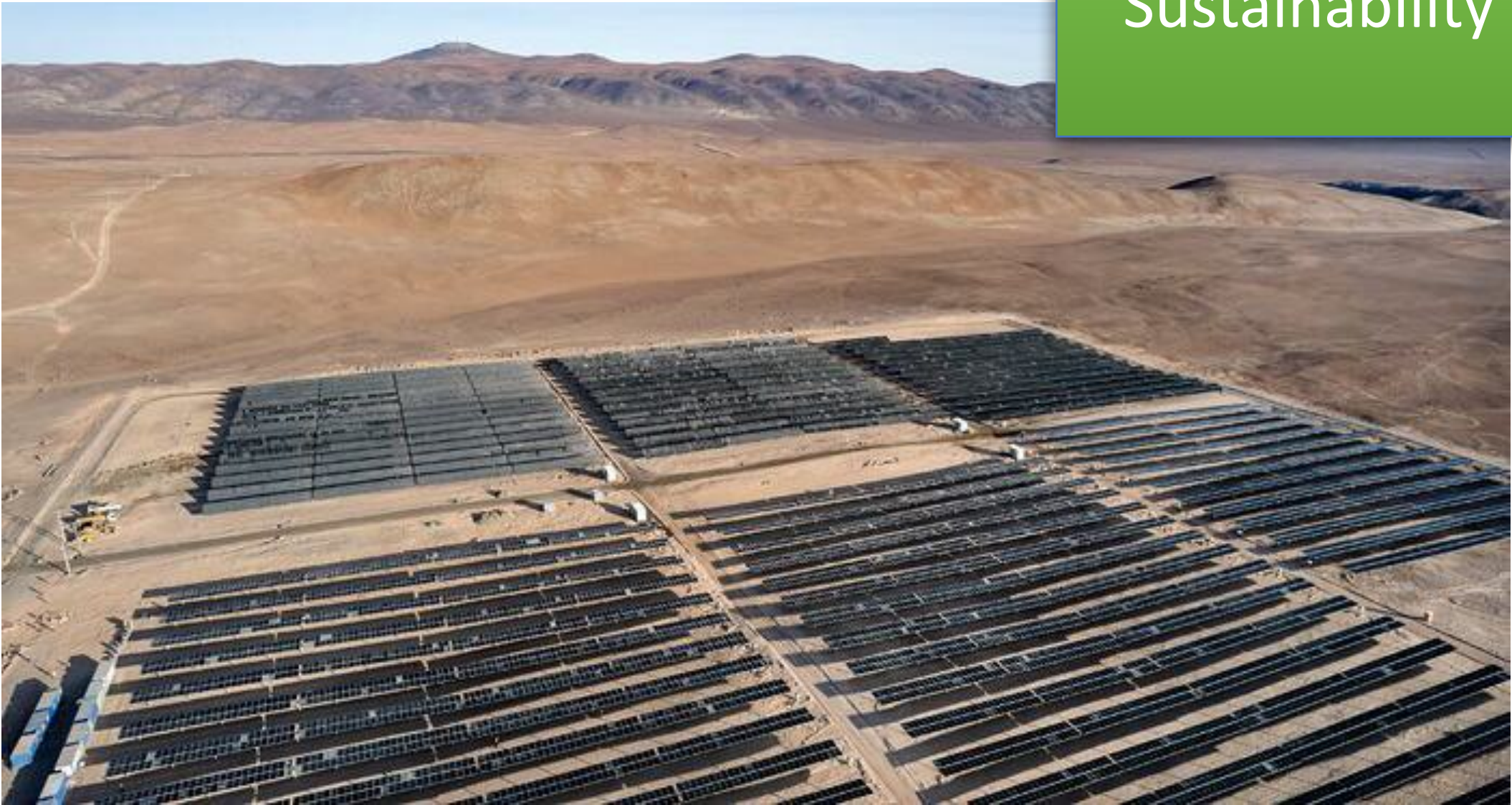
Paranal solar plant - 9 MW (Filippi et al, 2022)
